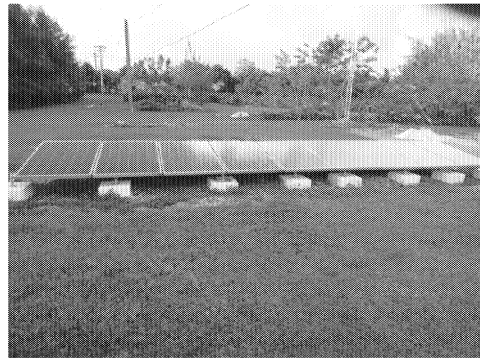
アクアポニック施設のポンプ等の電力を太陽光発電で補う（電力量の調査）
